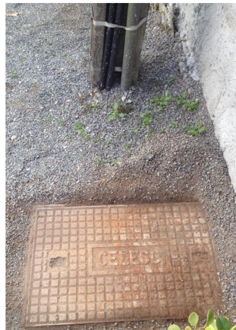
Caixa de Passagem junto ao Poste
