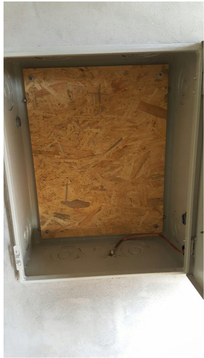
Caixa do Medidor de Energia
