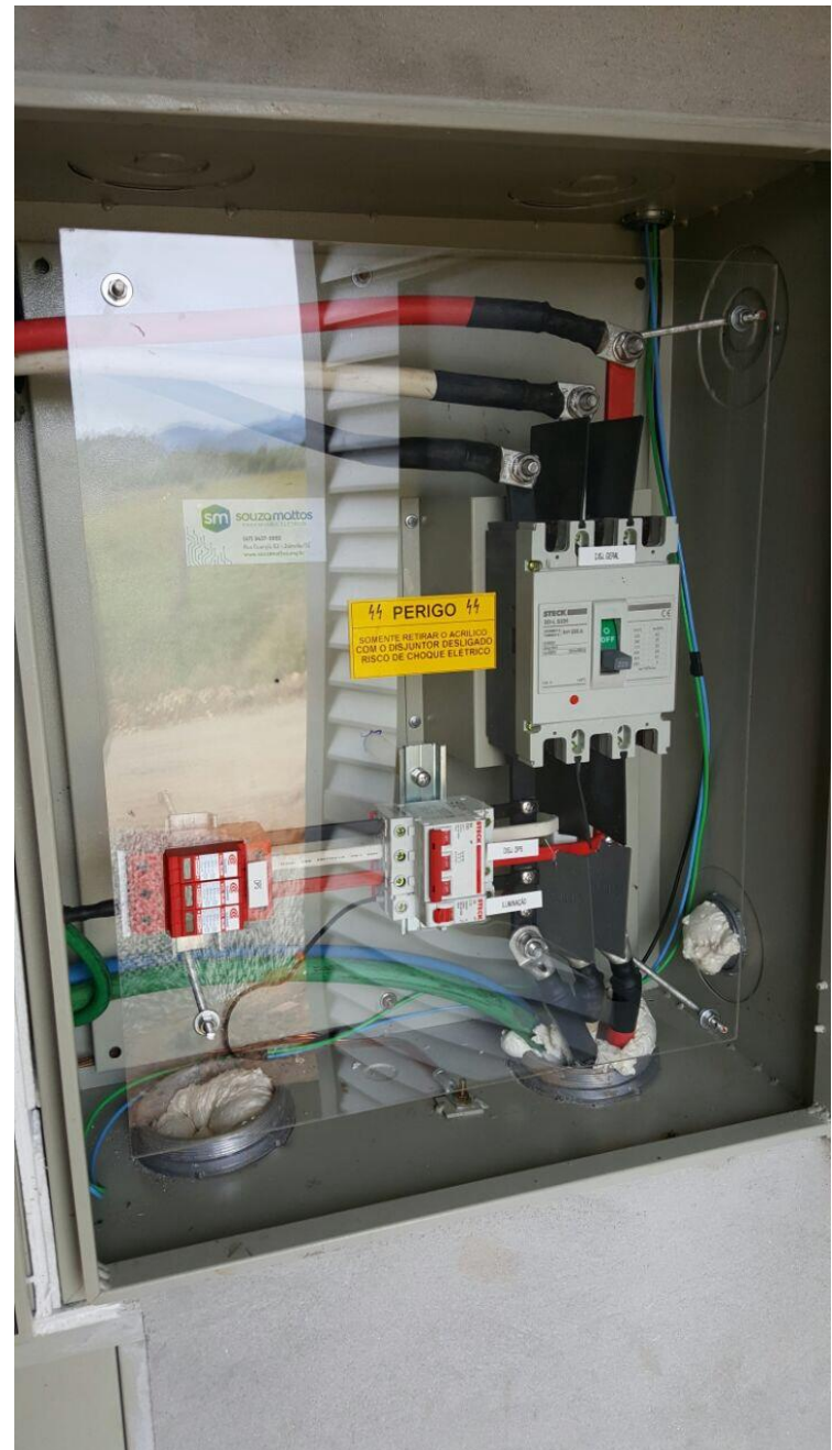
Proteção (Disjuntor e DPS)
